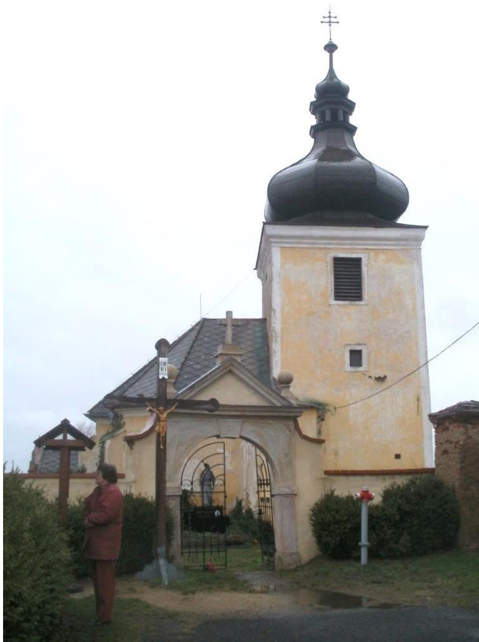
Obr. 125: Obdobně chátřá i kostel ve Skořicích
